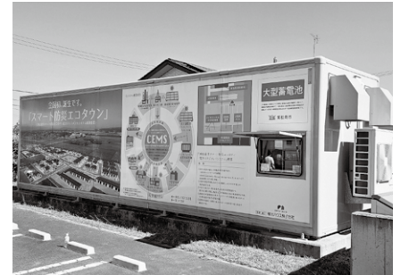
【スマート防災エコタウンの大型蓄電池】
